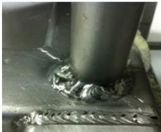
Imagen 5. Las soldaduras insalubres no son lavables a nivel microbiológico
