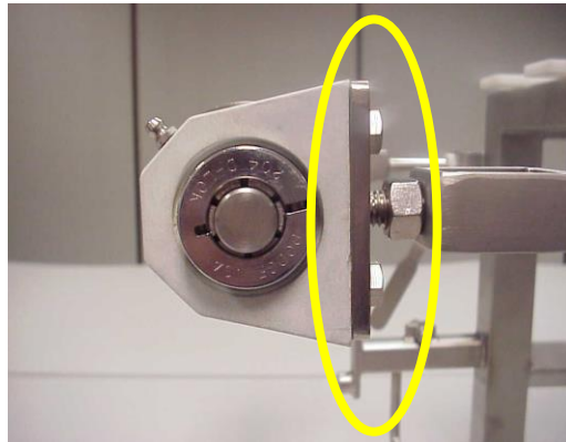
Imagen 23. Junta empalmada formada por la carcasa del balero y la estructura o marco del equipo, donde Listeria spp. había establecido un nicho y la estructura se había oxidado
